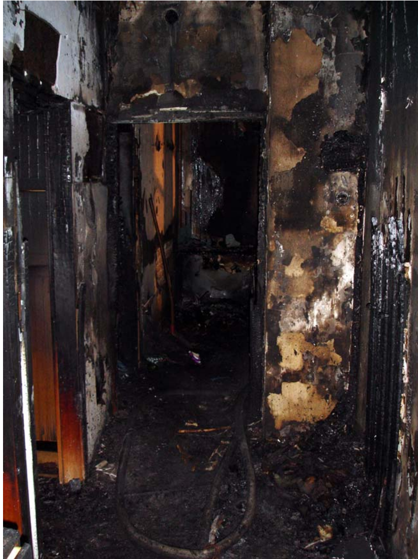
Blick in den Flur zur ausgebrannten Wohnung im Erdgeschoss. (Foto: Einsatzdokumentation FF Bad Harzburg).
