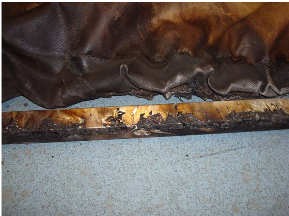
Detailaufnahme vom Rauchverschluss
